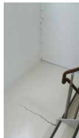
壁にヒビ割れ が出来ている
